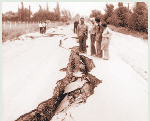
Efectos de licuefacción en San Juan (Causete)
