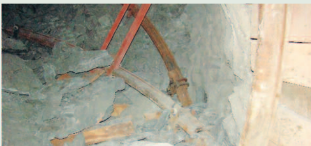
Figura 9. Galería derrumbada en una mina
