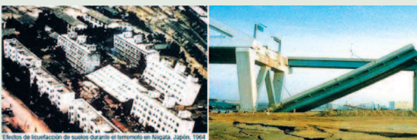
Figura 10. Estructuras afectadas por el fenómeno de licuefacción
